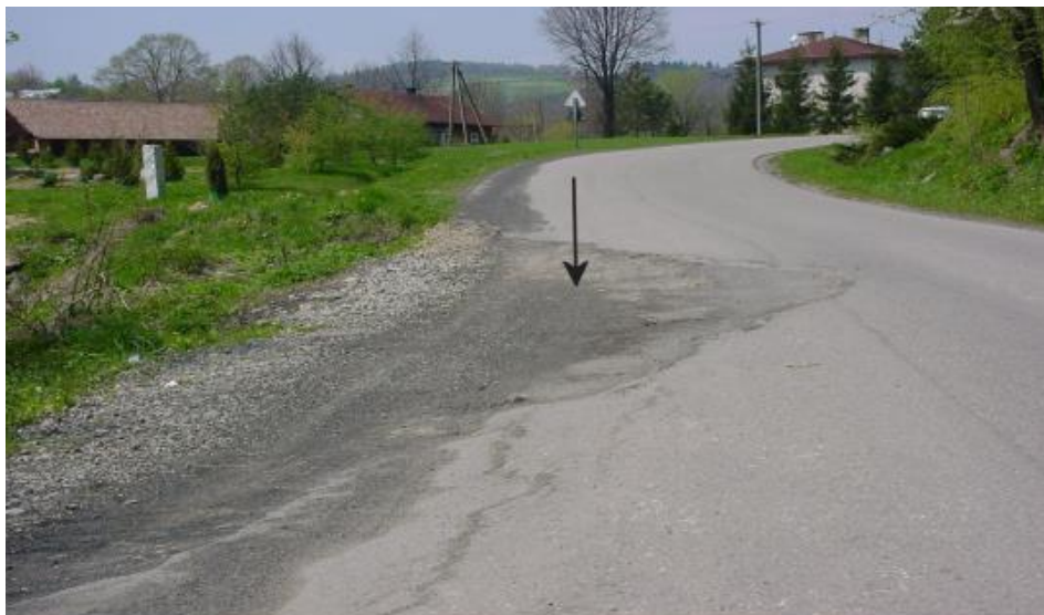
Fot. 1. Osuwające się droga powiatowa relacji Szymbark–Szalowa
