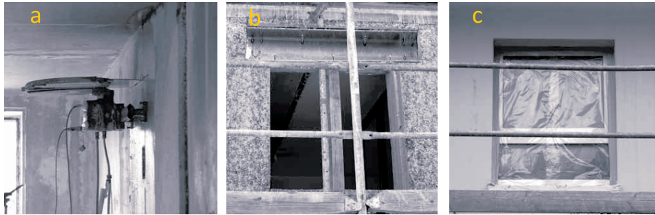
Rys. 2. Przykład wykonania nowego otworu okiennego w zewnętrznej ścianie nośnej budynku prefabrykowanego: a) wycinanie otworu za pomocą piły ściennej; b) otwór ze stalową belką nadprożową; c) gotowy otwór wraz z zamontowanym oknem [1]
