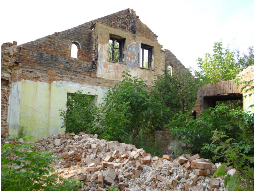
Pozostałości dworku w Chronówku, który spłonął w 2009 roku
