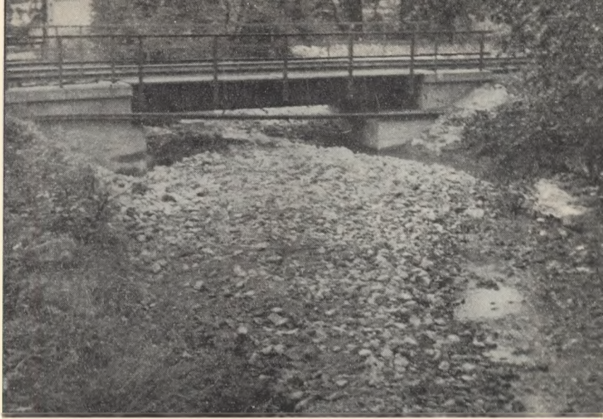
Fot. 6. Akumulacja żwirów po powodzi w 1972 roku powyżej mostu kamiennego w Suchej Beskidzkiej
